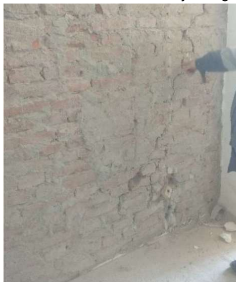
Pukotine širine veće od 10 mm
